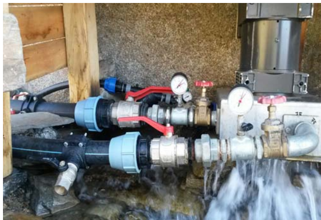
Fig. 89 - Sempre presso la Casa di caccia sono state installata una centralina elettrica e posate le relative tubazioni, valvole scarico, raccordi. Foto D. Carnicella
