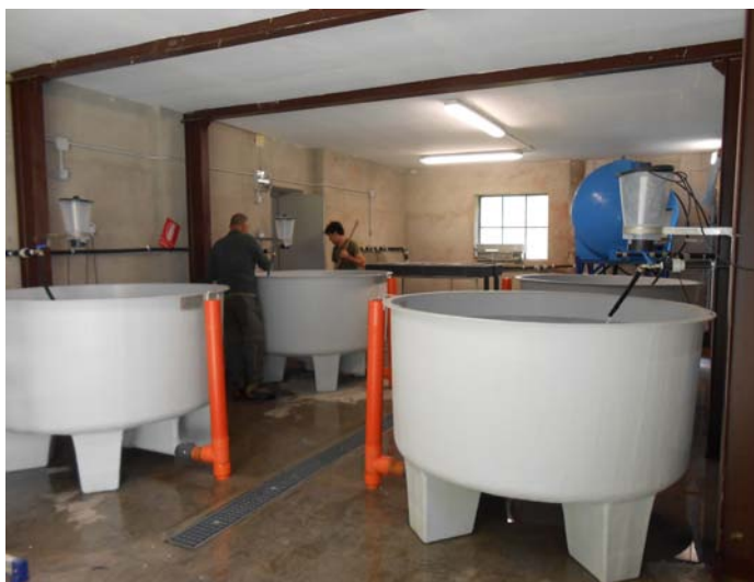
Fig. 96 - I lavori presso l'incubatoio ittico di Piantonetto oltre all'installazione di vasche e impianti idrici hanno riguardato l'installazione di impianto elettrico, copertura volta con cartongesso e tinteggiatura. Foto M. Ottino
