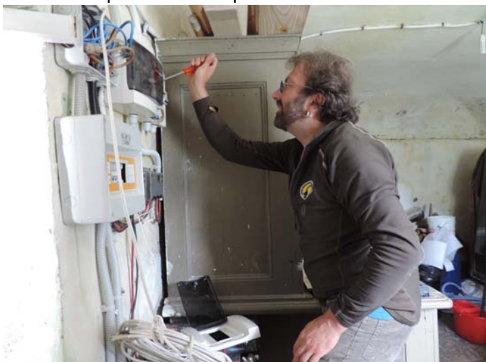
Fig. 95 - Completamento impianto elettrico cantine sede della sorveglianza di Rhêmes Notre Dame. Foto B. Rosai
