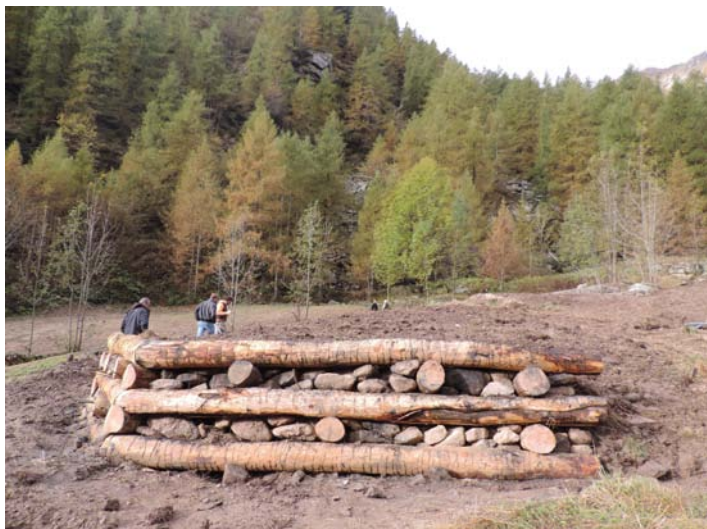
Fig.72 – Sono state realizzate una palificata ed una gabbionata a difesa e regolarizzazione della giacitura dei terreni del Centro "L'uomo ed i coltivi". Foto B. Rosai
