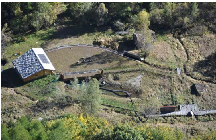
Fig. 75 - L'area del Centro per la conservazione dei corsi d'acqua che sarà interessata dai lavori di costruzione del vallo. Foto M. Ottino
