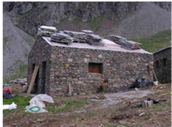
Lavori di manutenzione lungo la Tappa 1-550 da loc. Loseraì al Rifugio Città di Chivasso, Ceresole Reale
